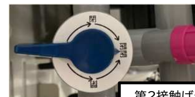
第2接触ばっ気槽 散気管AB両側閉
