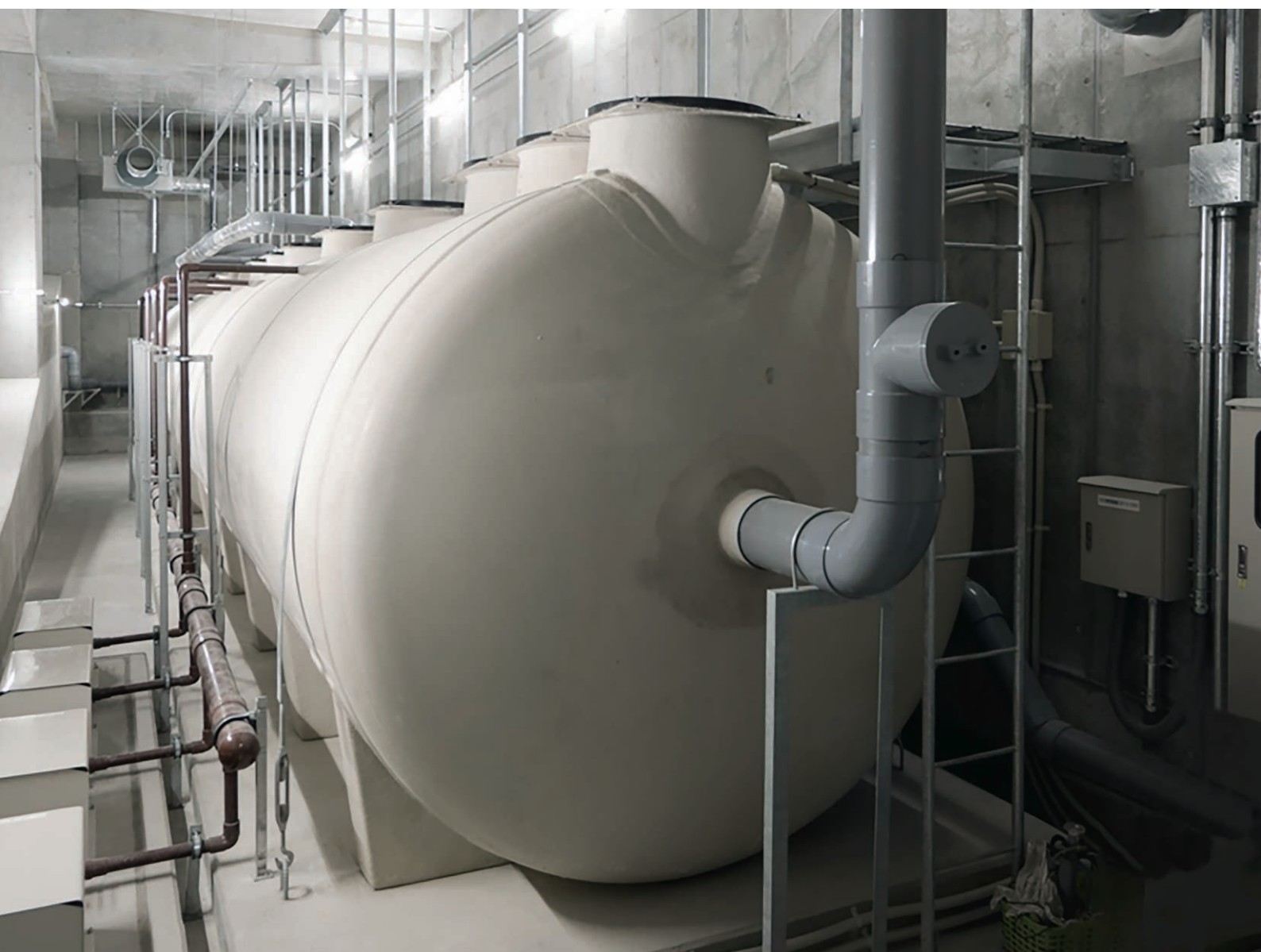
当社が施工したマンションのディスポーザ処理槽です。定期的にメンテナンスも実施しています。 (住設環境機器事業・環境プラント事業部)
